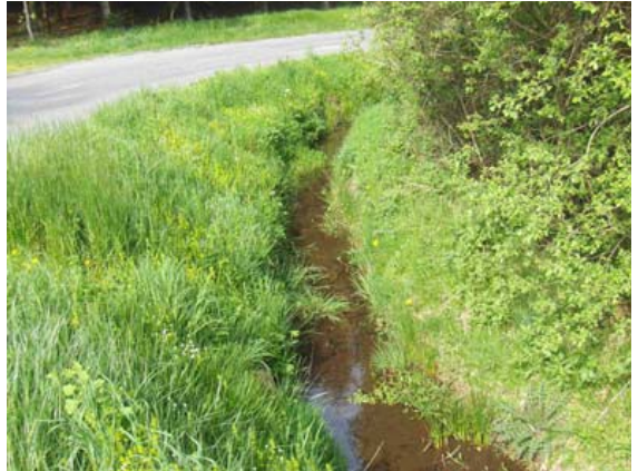
2. Cours d'eau déplacé (Le Margnès - 81)
