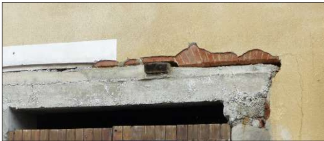
linteau clavé et chanfreiné remplacé dans un premier temps par une baie à chambranle simulé puis par un linteau de béton
