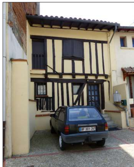
Façade en pans de bois 17e siècle, banalisée par l'apport d'un crépi inadapté et le traitement trop sombre des bois
