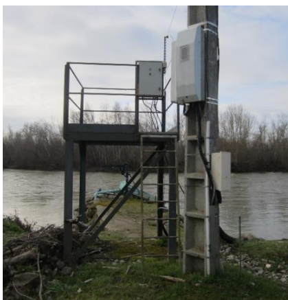
Vue de l'armoie électrique située sur pilotis
