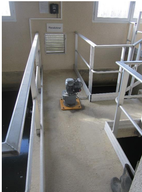
Vue de la bache de floculation
