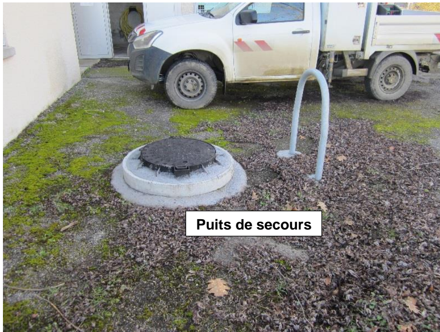
Vue extérieure du puits de secours alimentant ponctuellement la commune de Montech
