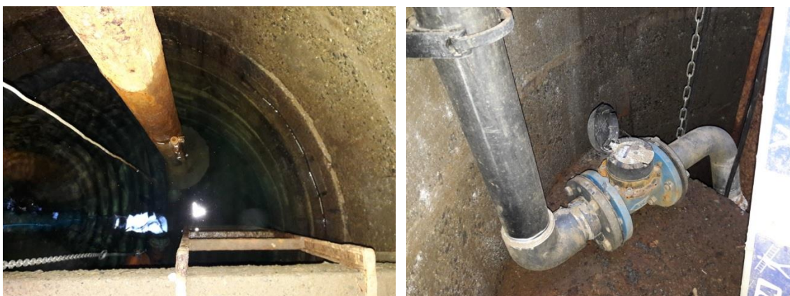
Vue de l'intérieur du puits de secours et son compteur (ITRON – 8214PT004) (Mai 2019)
