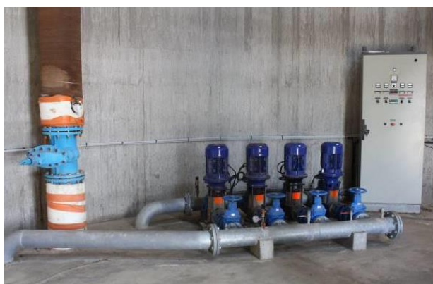
Vue du surpresseur du château d'eau de Montech
