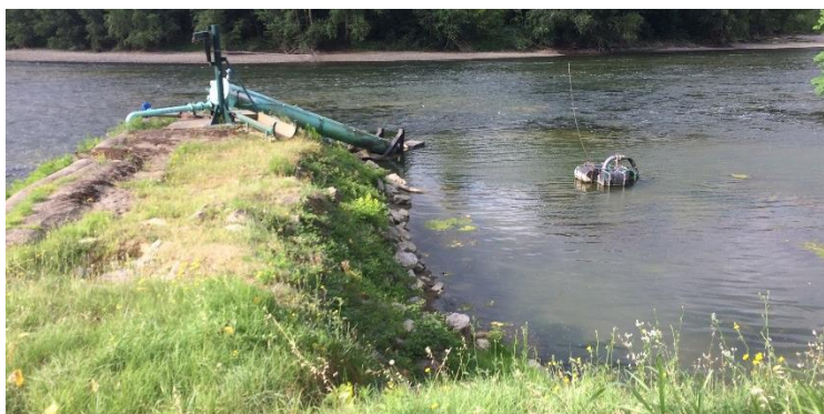
Vue du pompage de surface mobile (radeau) mis en place
