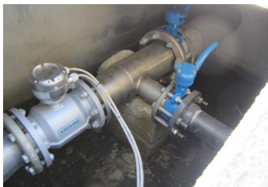
Débitmètre en sortie d'usine
