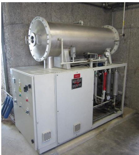
Vue du générateur d'ozone
