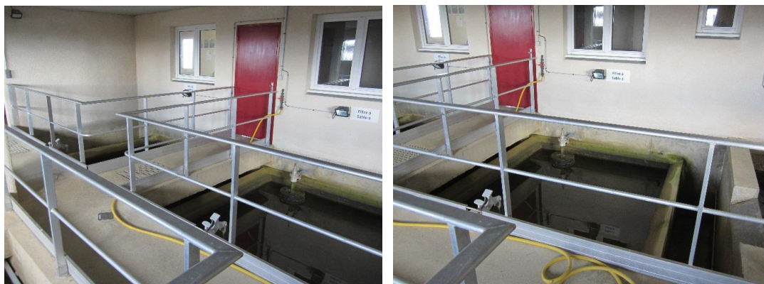
Vue des deux filtres à sable
