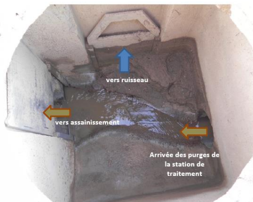
Vue du regard de rejet des eaux de l'usine
