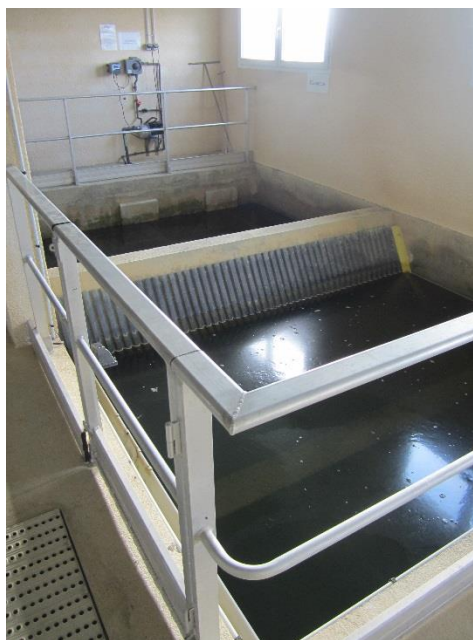
Vue du décanteur lamellaire
