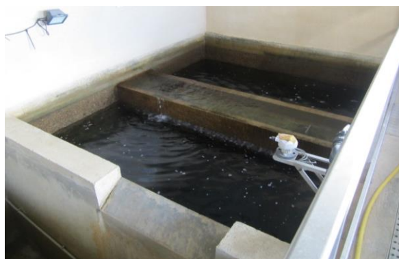
Vue du filtre à charbon actif
