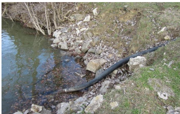
Vue du système de pompage de secours mis en place
