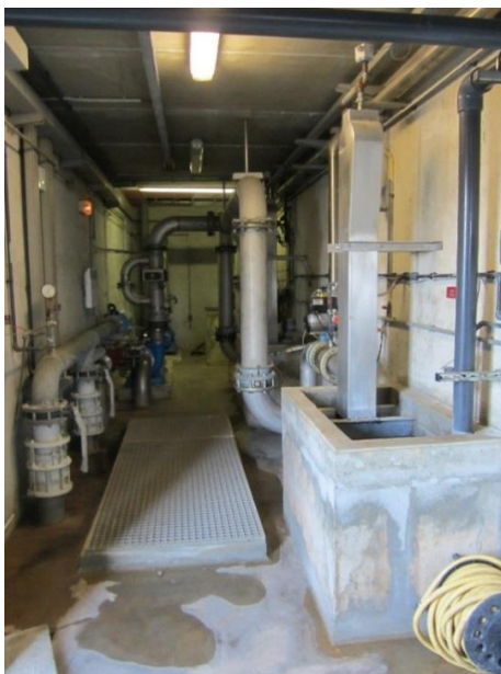
Vue du regard d'accès à la bêche d'eau traitée (enterrée) et des groupes de distribution en arrière-plan
